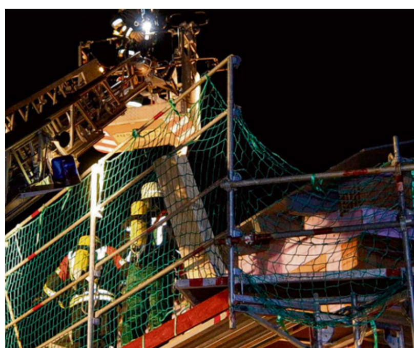
Dutzende Feuerwehrleute waren in der Nacht zum Samstag in Ritzisried im Einsatz. Dort brannte der Dachstuhl eines Neubaus. Foto: Wilhelm Schmid
